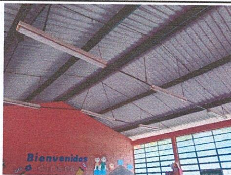
FOTO 4. Las lámparas se encuentran quemadas y el cable eléctrico en mal estado.
