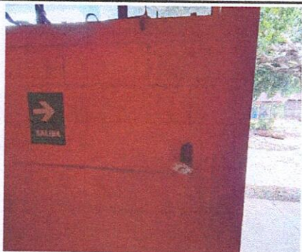
FOTO 3. Se puede observar el mal estado en que se encuentran los apagadores y cables de energía eléctrica.
